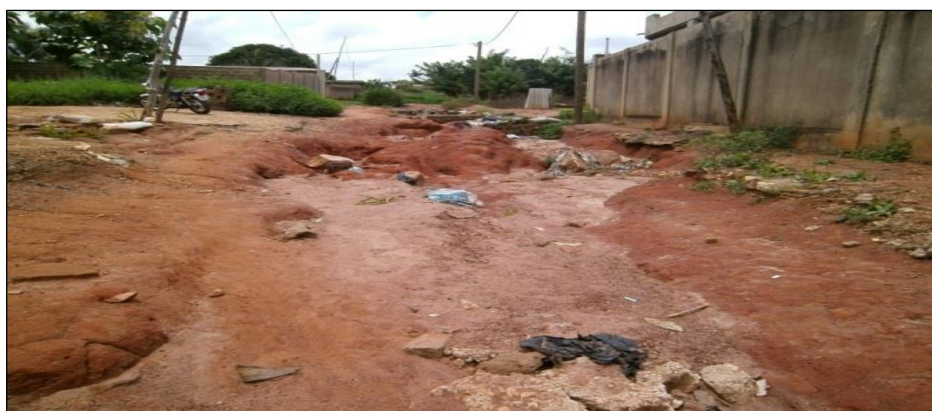
Photo A : Rue entaillée par un ravin à Agbavi
