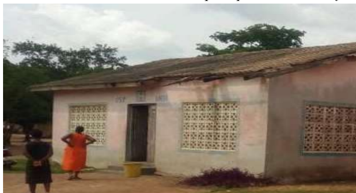
Photo n°2 : Une Unité de Soins Périphériques délabrée à Payoka
